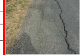
Décollement : Les problèmes de décollements de couches Perméabilité : Il s'agit de signaler des zones perméables Ressuage : Ressuage ( sur ESU : remontée de liant p
